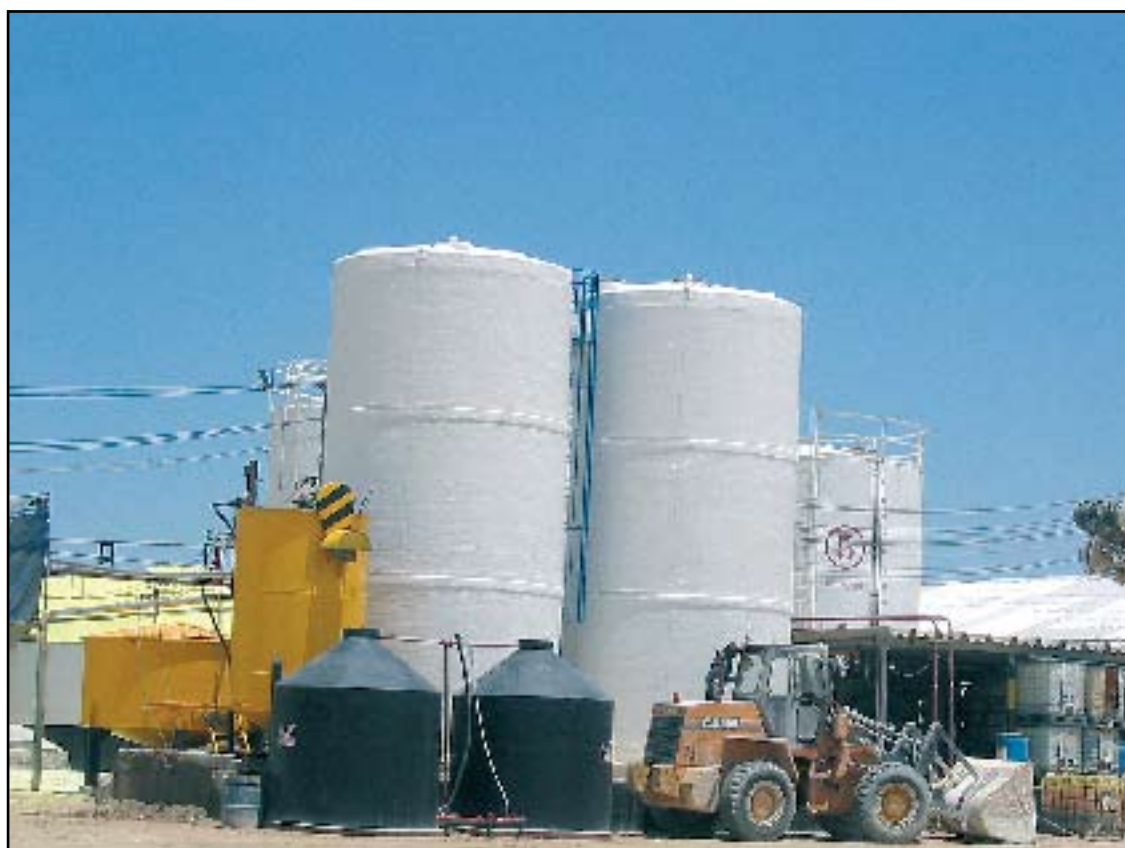
Tanques donde se produce el UAN 30 en la planta de ISUSA en ruta 1
